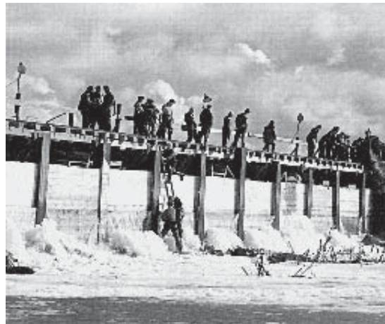
Wie eine Festungsmauer wird der Deich zwischen Land und Meer gebaut. Das Bild zeigt den Deichschluss des Hauke-Haien-Kooges 1959.
